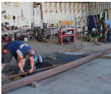
Les producteurs ont cherché à réaliser le plus de tâches possible avant le chantier. Ils ont coupé eux-mêmes les tiges de l'armature du béton et les ont pliées à l'aide de leur fendeuse à bois.
