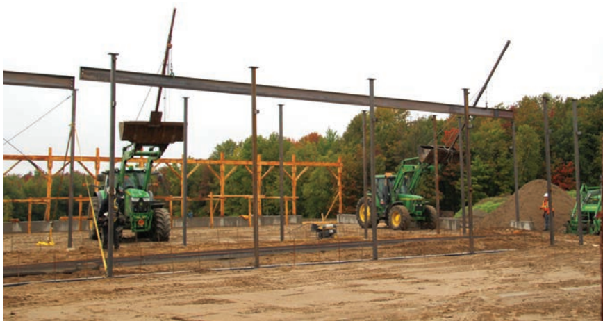
L'imagination au travail. Pour hisser les poutres en H, ils ont utilisé deux tracteurs munis d'une « chèvre ». Les poutres de 60 pieds pesaient une tonne.
